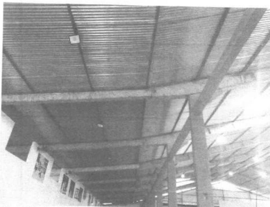
Imagem 08 – ponto de refletores da arquibancada do lado esquerdo, inclinação da cobertura metálica.
